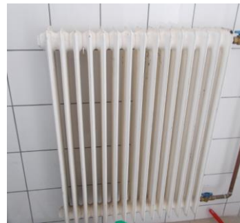
Üzemelő hűtési rendszerhez csatlakoztatott radiátor
