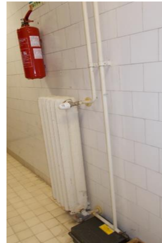
Termostatikus szeleppel ellátott radiátor a prospektúra épületében
