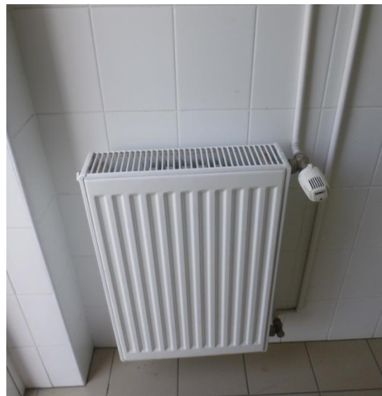
A helyiségfűtést ellátó, termostatikus szeleppel szerelt lemezzradiátorok egyike
